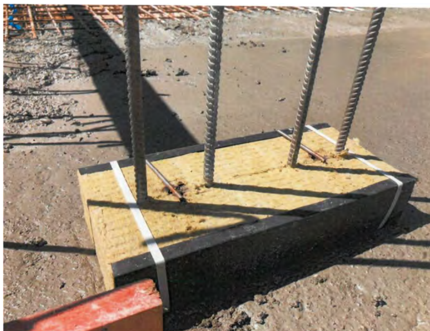
Abbildung 17: Fotografie aus Klagebeilage 20, angeblich ein teilweise eingebautes Anschlusselement des Typs NL 18 zeigend
